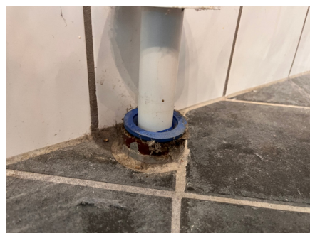
Membran oppbrett for avløp vaskemaskin.
