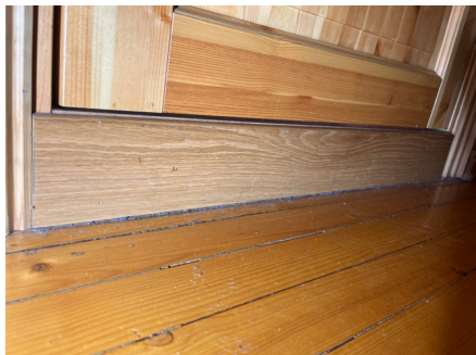
Luftespalte under døren
