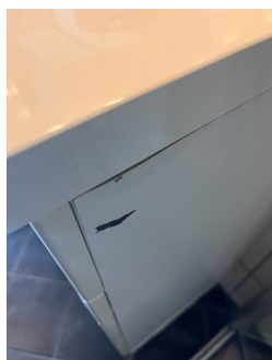
Fuktsvelling og skade på skapskrog
