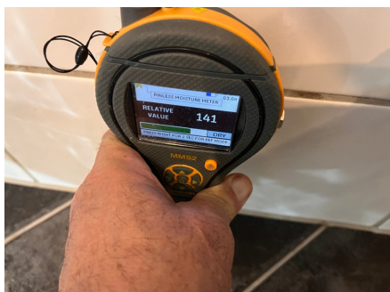
På vegg under blandebeater ved gulv
