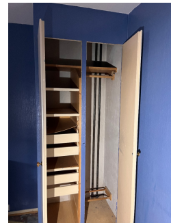
Plassbygget skap i dårlig stand.
