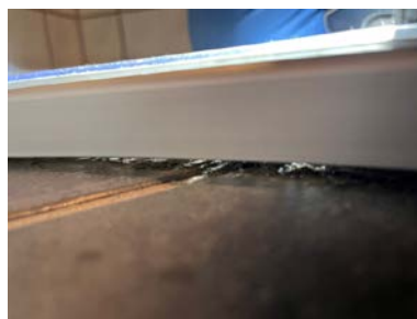
Vann kan renne under dusjvegg til sluk
