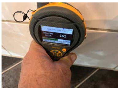
På vegg under blandebatteri ved gulv
