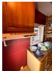
Mangler en del på betjeningspanel
