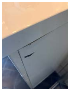
Fuktsvelling og skade på skapskrog
