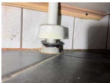
Membran på rørgjennomføring i gulvet
