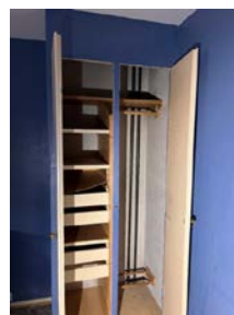
Plassbygget skap i dårlig stand.
