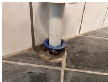
Membran oppbrett for avløp vaskemaskin.
