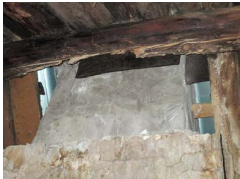
Fuktskader i rundt ene pipen og undertekkingen er dårlig
