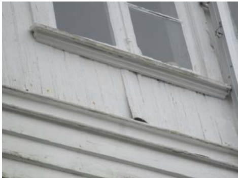
Skader i ene gavlveggen med stående tynn panel.
