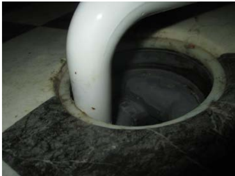
Sluk under dusjkabinett.
