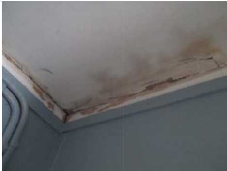
Eldre fuktmerker i gangen.
