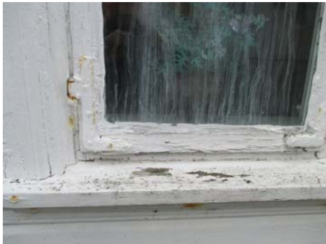
Større skader på enkelte vinduer.
