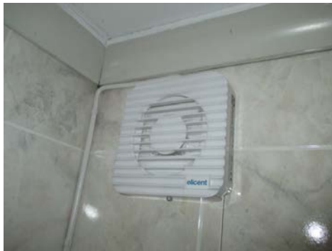
Vifte i ytterveggen.
