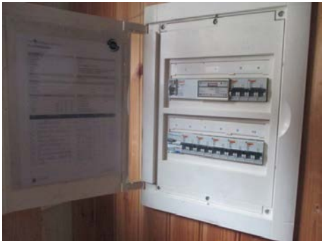
Sikringsskap i første etasje.
