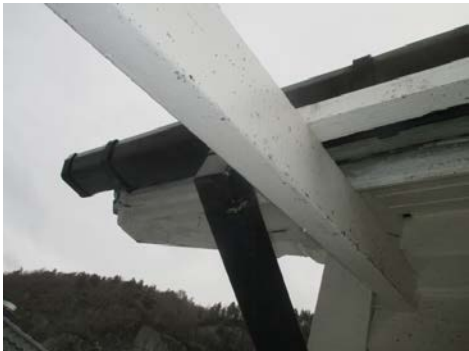
Takrenner med tilhørende deler er noe slitt.
