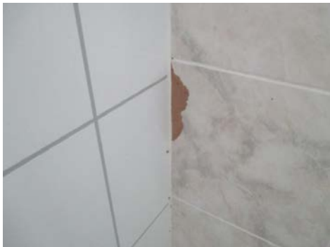
Noen skader på plater i ene hjørne.
