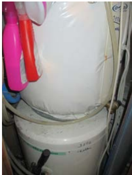
Flere mindre varmtvannsberdere.
