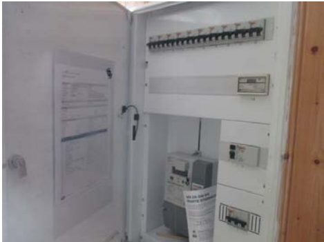
Sikringsskap i andre etasje.
