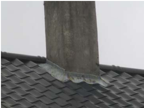
Eldre bunnbeslag på pipe
