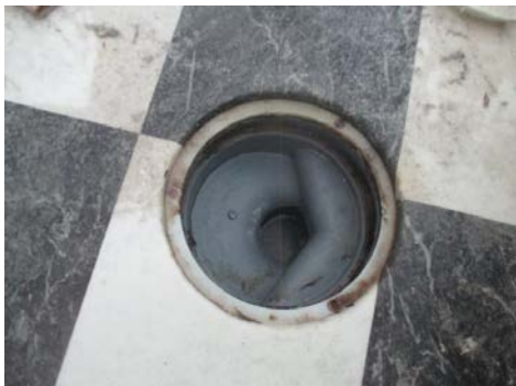
Sluk under dusjkabinett
