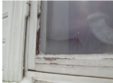
Vedlikehold må beregnes om vinduer skal bevares.
