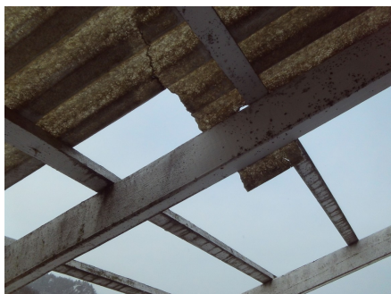
Plater mangler/skadet på enkelt overbygg
