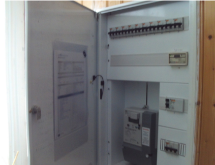
Sikringsskap i andre etasje.
