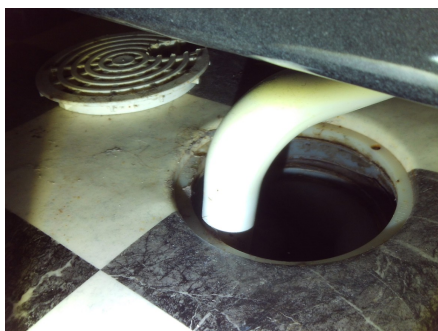
Sluk under dusjkabinett.
