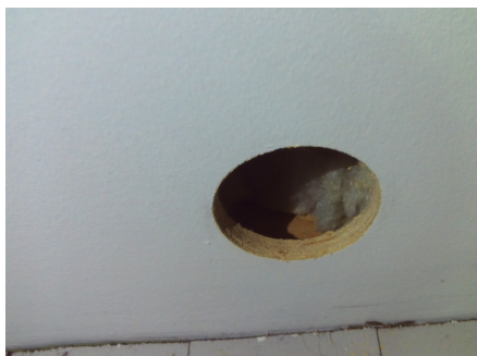
Hulltaking i trappegangen.
