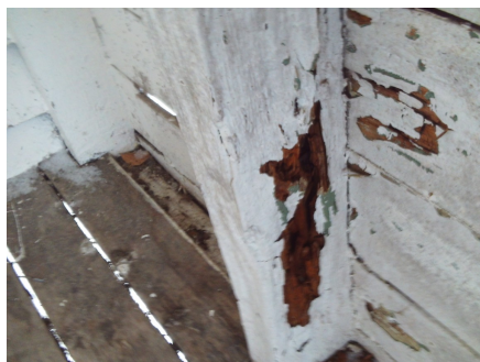
Råteskade på stolpe til rekkeverk.
