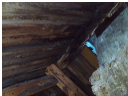
Deler av ene pipe på loftet.
