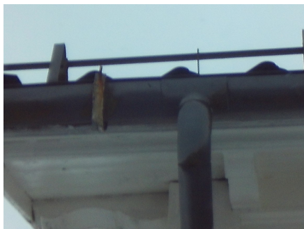
Eldre plastrenner med rust på rennekroker
