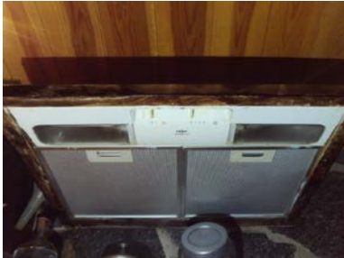
Ventilator med kullfilter.
