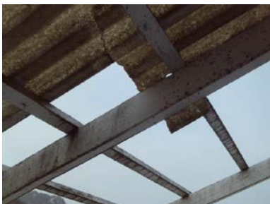
Plater mangler/skadet på enkelt overbygg
