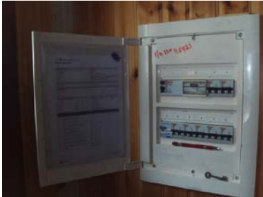
Sikringsskap i første etasje.
