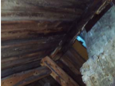
Noe fuktskader i rundt pipe og undertekkingen er dårlig.
