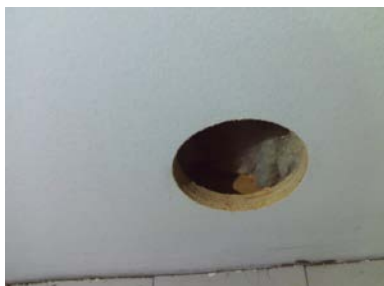
Hulltaking i trappegangen.
