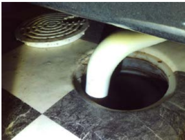
Sluk under dusjkabinett.
