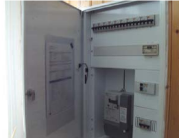
Sikringsskap i andre etasje.
