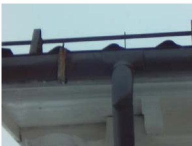
Eldre plastrenner med rust på rennekroker
