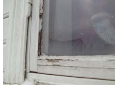
Vedlikehold må beregnes om vinduer skal bevares.
