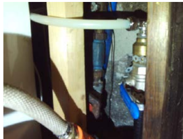
Innvendig stoppekran i et skap på enden av kjøkkeninnredningen i kjeller
