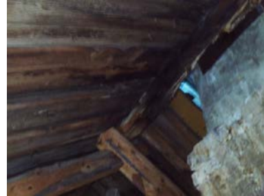
Deler av ene pipe på loftet.
