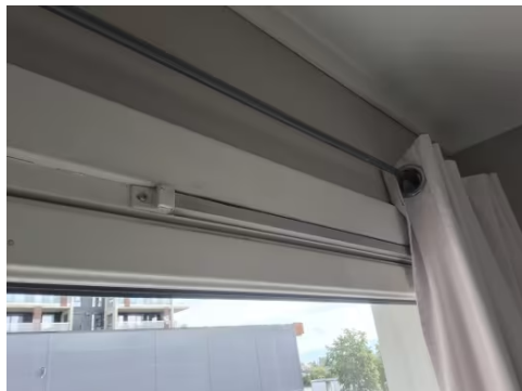
Naturlig tilluft via spalteventiler i vinduer.
