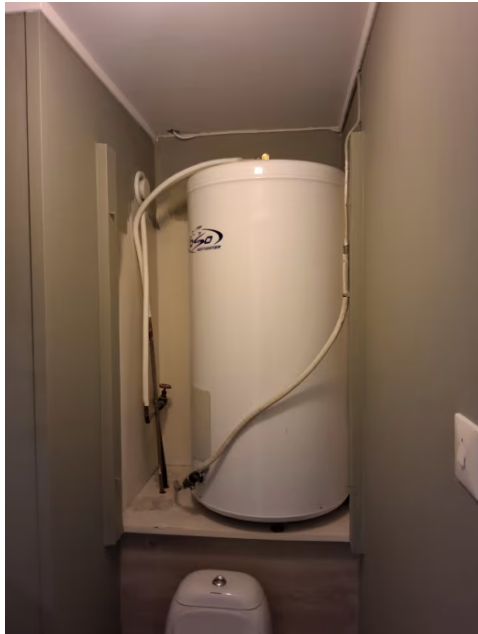
Varmtvannsbereder er plassert i toalettrom.
