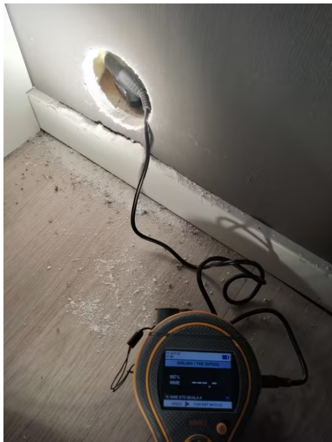
Bilde fra fuktmåling i veggkonstruksjon tilstøtende våtsone.
