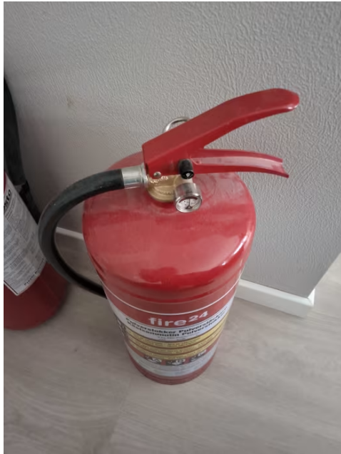
Brannslukningsapparat er plassert på soverom.
