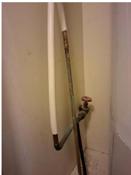
Hovedstoppekran er plassert i kasse bak toalett.
