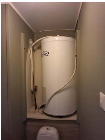
Varmtvannsbereder er plassert i toalettrom.
