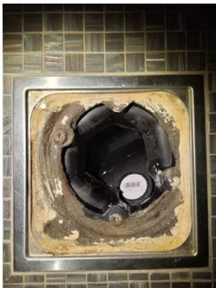
Eldre sluk på bad.
