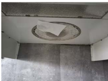
Avtrekkseffekten er testet med papir.
