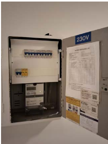
Sikringsskap er plassert i felles gang.
