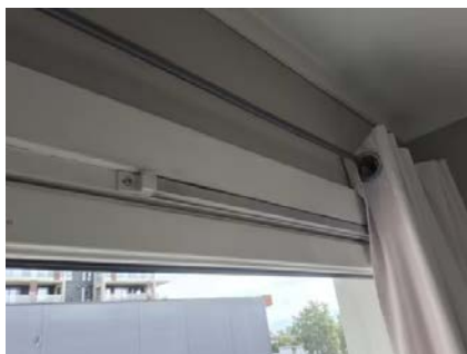
Naturlig tilluft via spalteventiler i vinduer.
