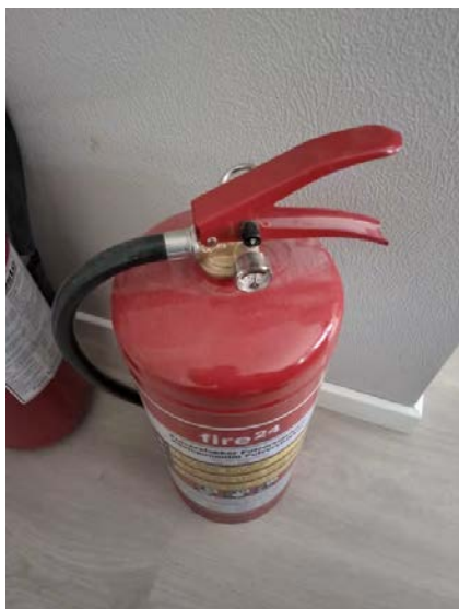
Brannslukningsapparat er plassert på soverom.
