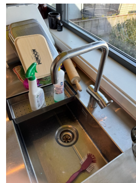
Foto viser funksjonstest av hovedstoppekran, stenger vann som tiltenkt.
