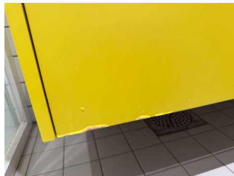
Foto viser svelling i dører til baderomsinnredning.
