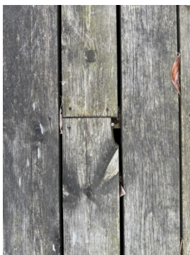
Foto viser skade i terrassebord.
