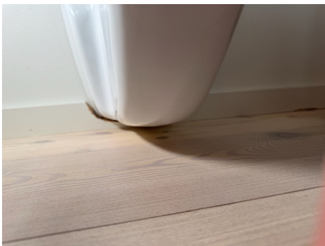
Ingen drenshull eller waterguard under toalett.
