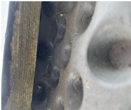
Foto viser lufting som er tett som følge av grunnmursplast som går opp i luftespalte.
