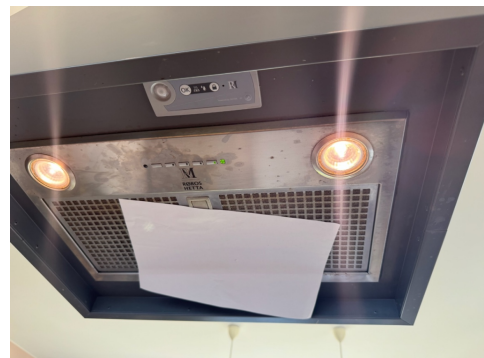
Foto viser test av avtrekk.
