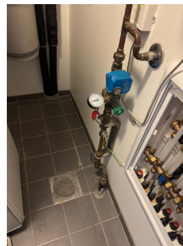
Foto viser stamme for hovedstoppekran. Det er ikke etablert vannmåler.
