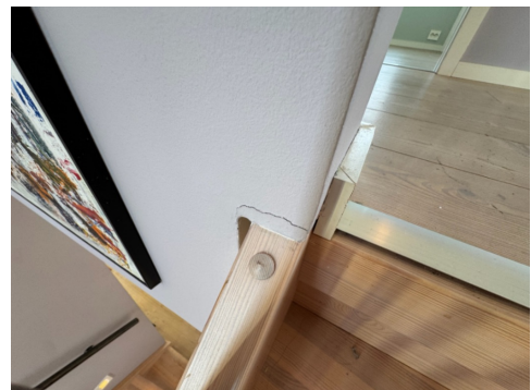
Foto viser eksempel på riss/ sprekk i overflater.
