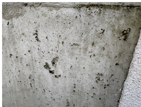
Uthulinger i grunnmur.
