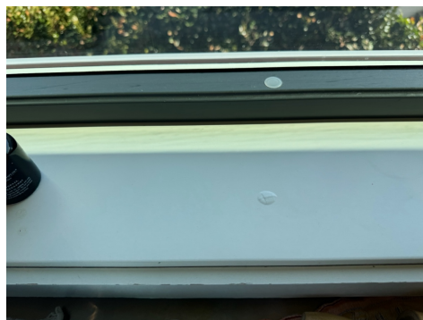
Foto viser eksempel på skade i foring inv.
