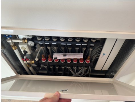
Samleskap i toalettrom for vannbåren varme.
