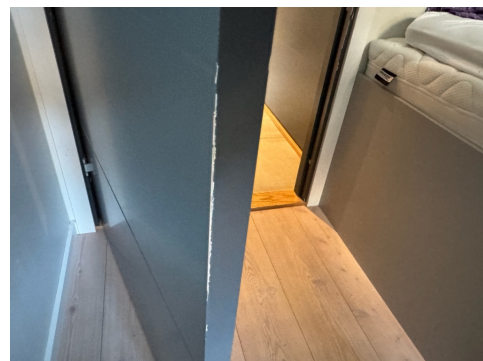
Foto viser eksempel p  overflateslitasje p  inv. d r.
