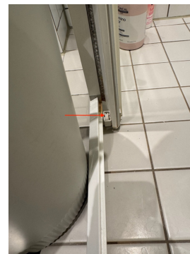
Foto viser dusjdør som har løsnet fra skinne.
