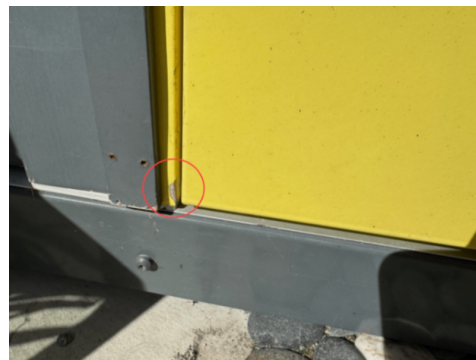
Ytterdør - hoveddør, skade i karm.
