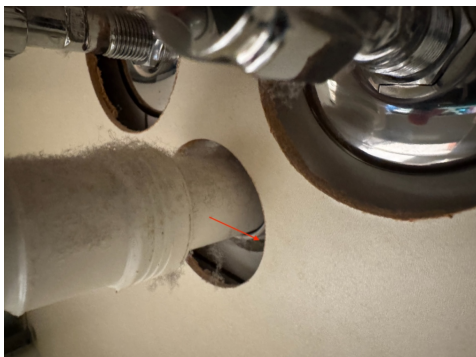
Foto viser manglende fugemasse mellom flis og avløpsrør for servant.
