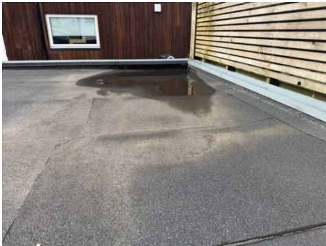
Foto viser gjenstående vann på overflaten.
