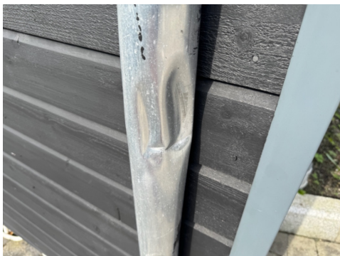
Foto viser bunk i nedløpsrør
