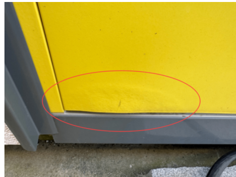
Ytterdør - vaskerom/ bi-inngang, sveller i bunn.
