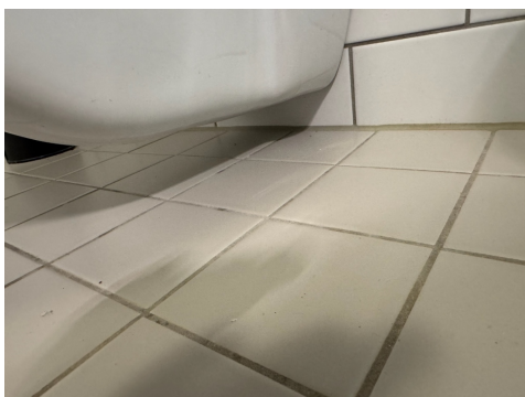
Foto viser manglende drenshull for lekkasjevann.
