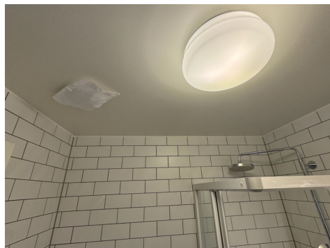
Foto viser test av ventilasjon.
