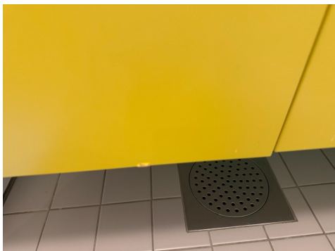
Foto viser svelling i dører til baderomsinnredning.
