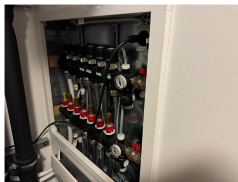
Samleskap i teknisk rom for vannbåren varme.
