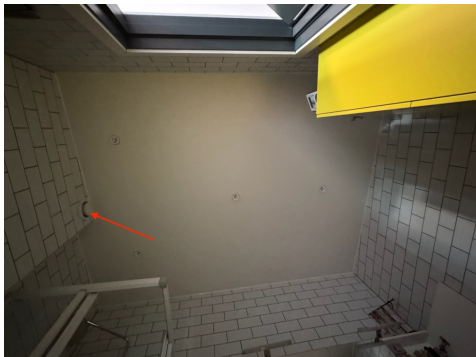
Foto viser inv. tak og ventilhette på vegg.
