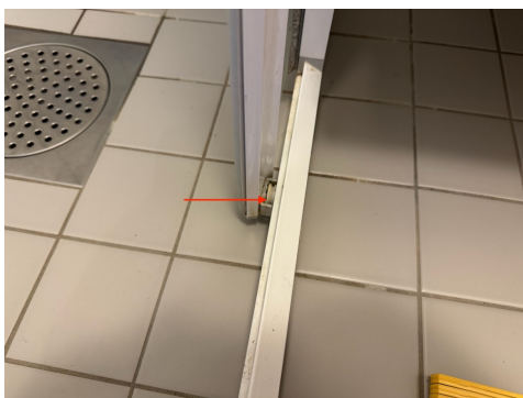
Foto viser dusjdør som har løsnet fra skinne.
