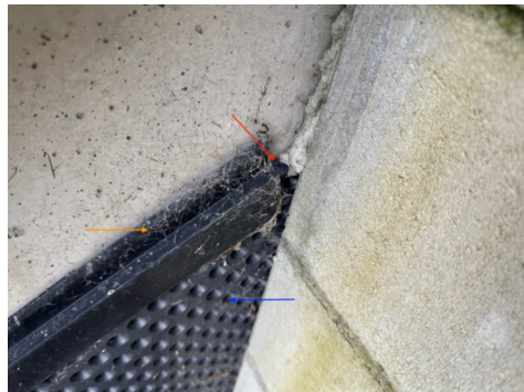
Rød pil viser utetthet mellom topplst (oransje pil) og grunnmursplast (blå pil).
