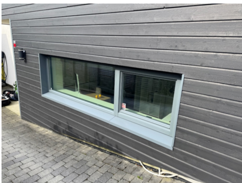
Foto viser eksempel på kledning som går lavt til bakke, mot hovedinngang er kledning i kontakt med bakkenivå
