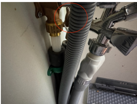
Foto viser vannledninger som er løsnet fra vegg.
