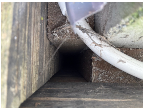
Foto viser manglende musesikring i hjørne.
