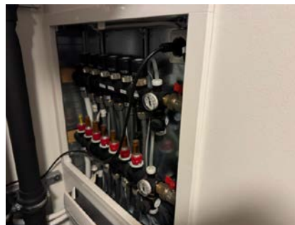
Samleskap i teknisk rom for vannbåren varme.
