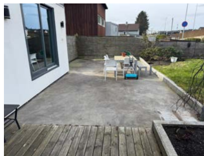
Foto viser oversikt ved skyvedørsfelt.
