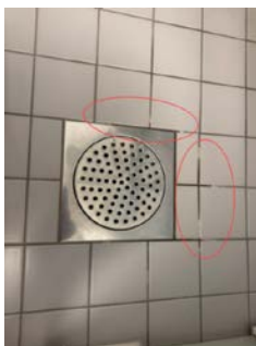
Foto viser saltutslag rundt sluk.
