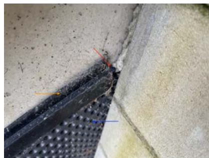
Rød pil viser utetthet mellom toppliste (oransje pil) og grunnmursplast (blå pil).
