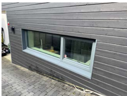
Foto viser eksempel på kledning som går lavt til bakke, mot hovedinngang er kledning i kontakt med bakkenivå
