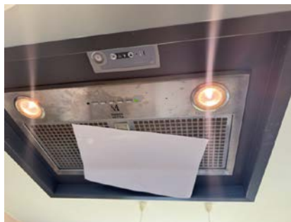
Foto viser test av avtrekk.
