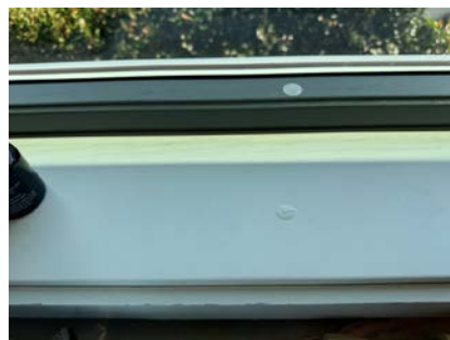
Foto viser eksempel på skade i foring inv.
