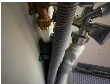
Foto viser vannledninger som er løsnet fra vegg.
