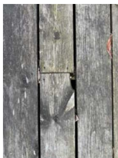
Foto viser skade i terrassebord.
