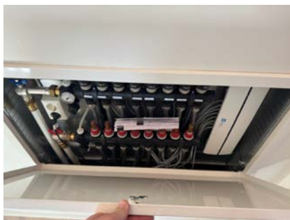
Samleskap i toalettrom for vannbåren varme.
