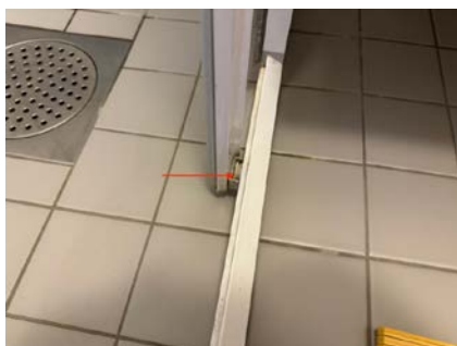
Foto viser dusjdør som har løsnet fra skinne.
