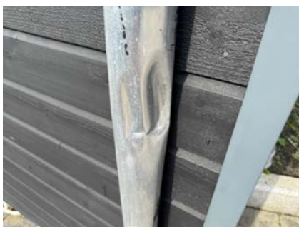
Foto viser bunk i nedløpsrør
