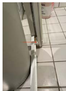
Foto viser dusjdør som har løsnet fra skinne.
