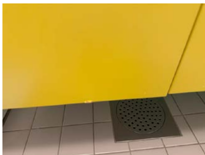
Foto viser svelling i dører til baderomsinnredning.
