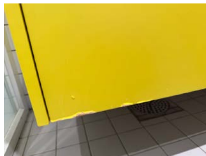
Foto viser svelling i dører til baderomsinnredning.
