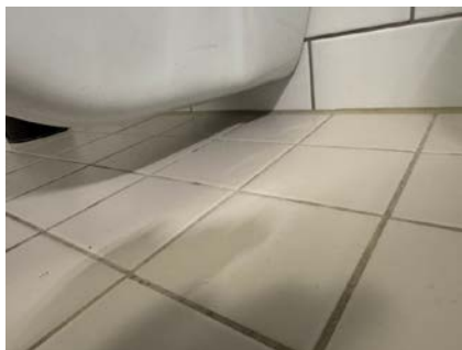
Foto viser manglende drenshull for lekkasjevann.
