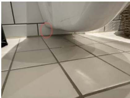
Foto viser sprekke i flis og manglende drenehull for lekkasjevann.
