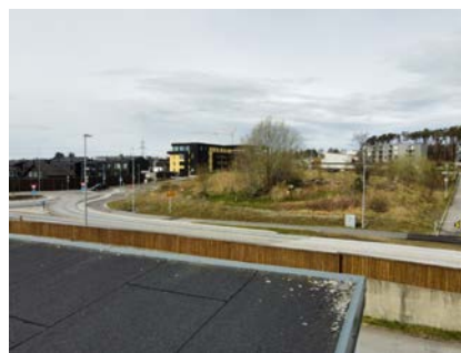
Foto viser mose på tak, registrert i hjørner og langs beslag nedover taket.
