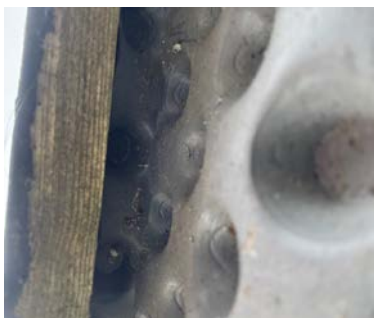
Foto viser lufting som er tett som følge av grunnmursplast som går opp i luftespalte.
