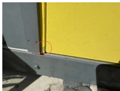
Ytterdør - hoveddør, skade i karm.
