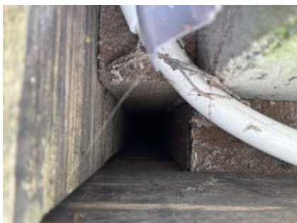
Foto viser manglende musesikring i hjørne.
