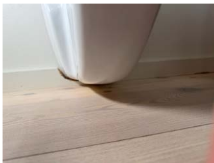
Ingen dreinsjull eller waterguard under toalett.
