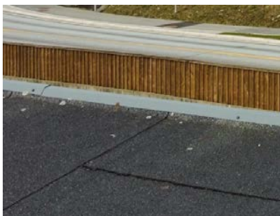
Foto viser rust i beslag
