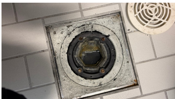
Eldre sluk på vaskerommet.
