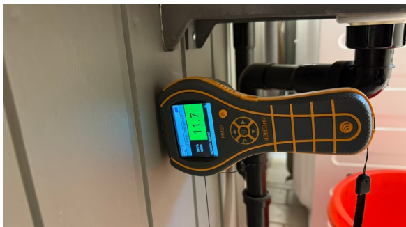
Fuktmåling i trevegg på vaskerommet.
