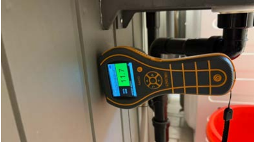
Fuktmåling i trevegg på vaskerommet.
