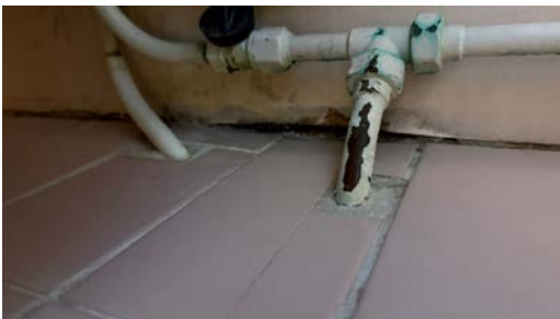
Utette rørgjennomføringer og overgang mellom gulvet og veggen
