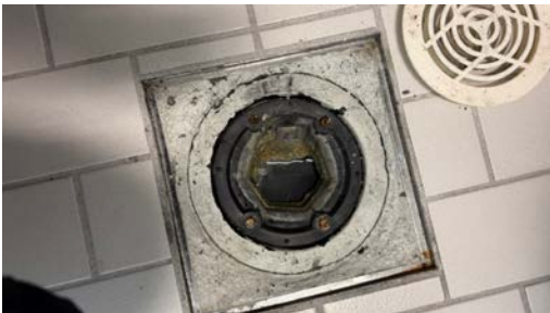
Eldre sluk på vaskerommet.
