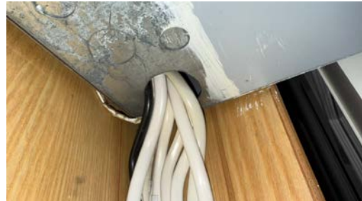
Eksempel på avviv ved kabelgjennomføring i skapet.
