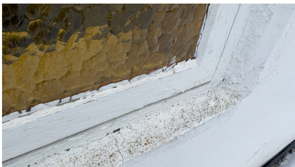
Avskaling av kitt på vindu i garasje.
