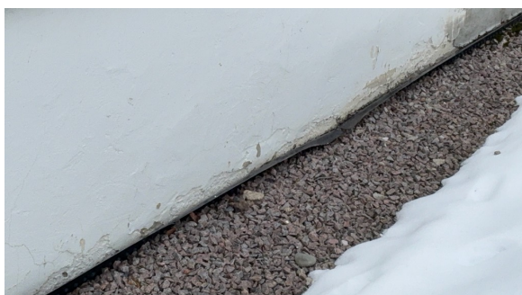
Det er ikke klemt avslutning på fuktsperre.
