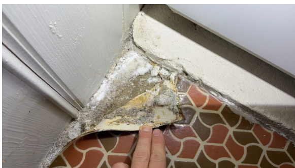
Saltutslag under gulvbelegg.
