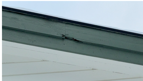
Råte i vindski
