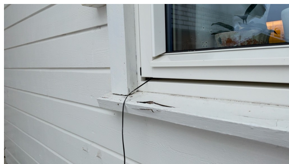
Eksempel på slitasje.
