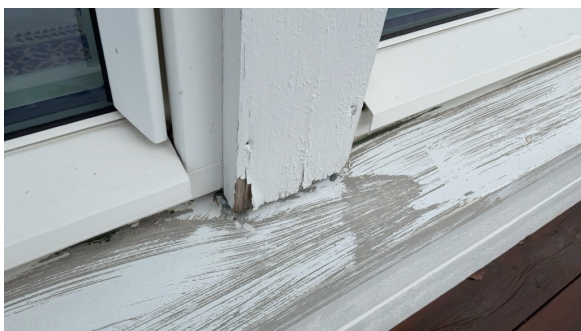
Eksempel på slitasje.
