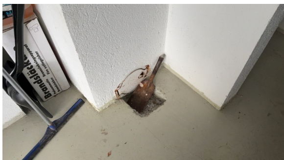
Sotluke i garasje i tilbygget del.
