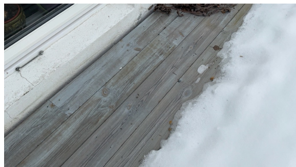
Eksempel på slitasje.
