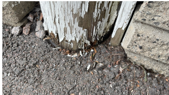
Begynnende råte i søyle.
