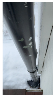
Eksempel på frostspreng på taknedløp.
