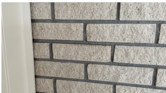
Eksempel på område med sprekk i fuger.
