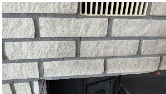
Eksempel på område med sprekk i fuger.
