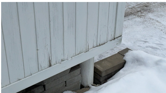
Eksempel på slitasje.
