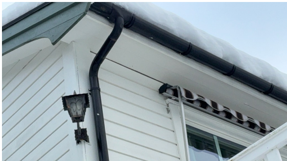
Spalte for lufting er liten, kan medføre kondens.
