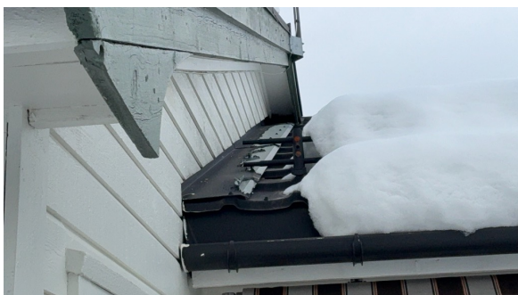
Eksempel på avskaling på beslag.
