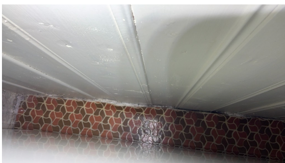
Saltutslag flere steder langs kant på gulvbelegg.
