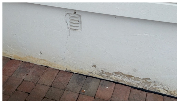
Eksempel på slitasje og sprekk i grunnmur.
