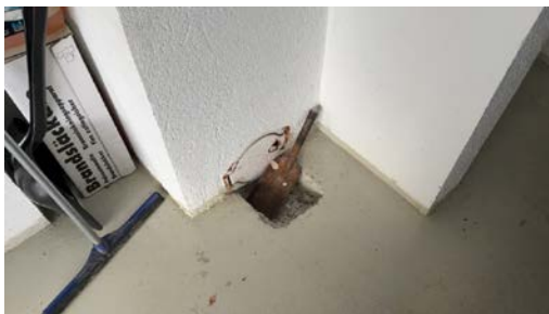
Sotluke i garasje i tilbygget del.
