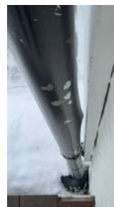
Eksempel på frostspreng på taknedløp.
