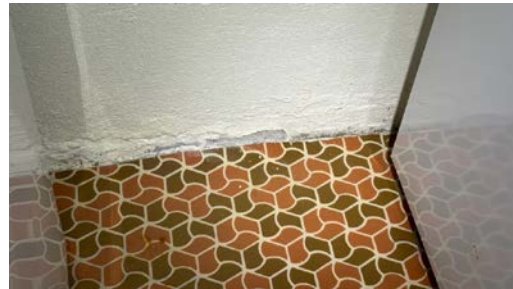
Saltutslag og avskaling nederst på vegg.
