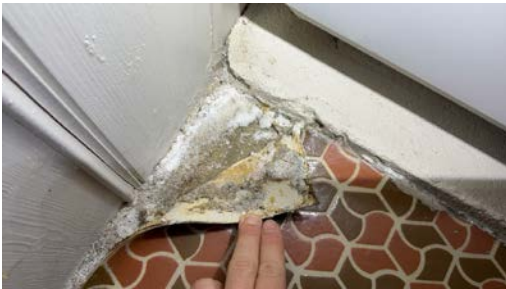
Saltutslag under gulvbelegg.
