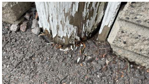
Begynnende råte i søyle.
