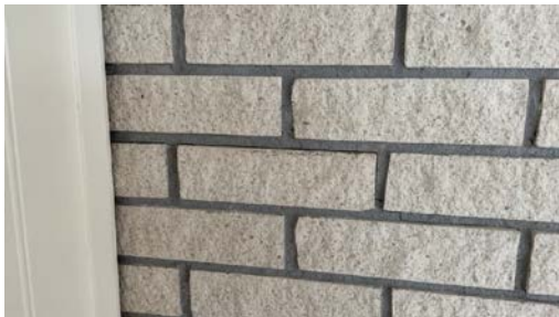
Eksempel på område med sprekk i fuger.
