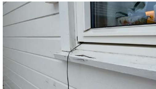
Eksempel på slitasje.
