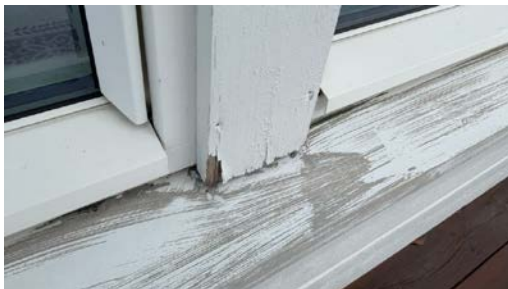
Eksempel på slitasje.
