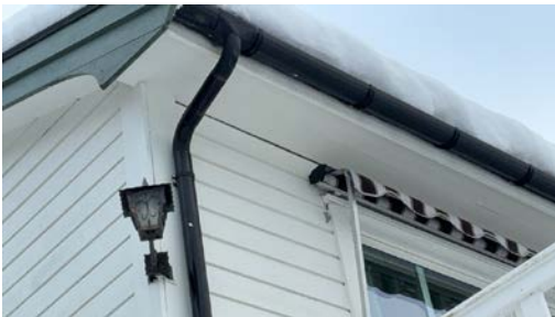
Spalte for lufting er liten, kan medføre kondens.
