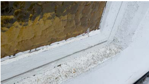
Avskaling av kitt på vindu i garasje.
