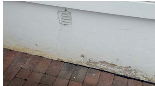
Eksempel på slitasje og sprekk i grunnmur.
