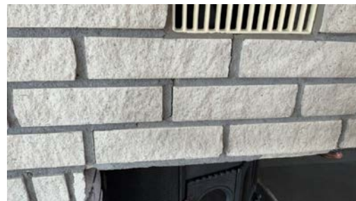
Eksempel på område med sprekk i fuger.
