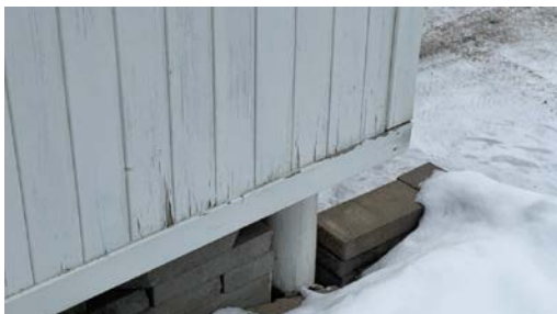
Eksempel på slitasje.
