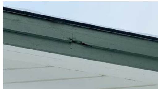
Råte i vindski
