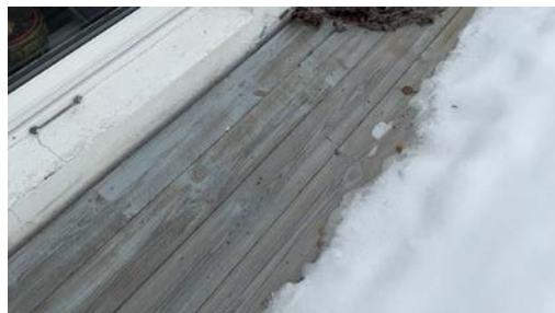
Eksempel på slitasje.
