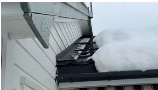
Eksempel på avskaling på beslag.
