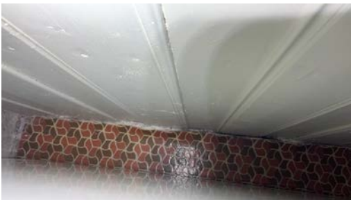
Saltutslag flere steder langs kant på gulvbelegg.
