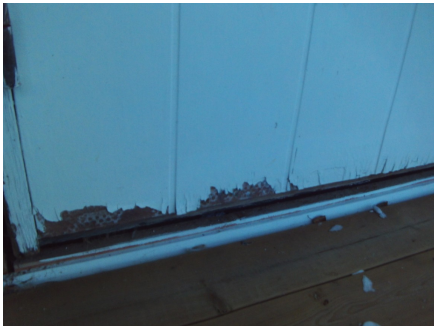
Balkongdør har skade på utvendig brystning
