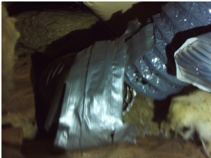
Brudd på ventilasjonsslange på knekott.
