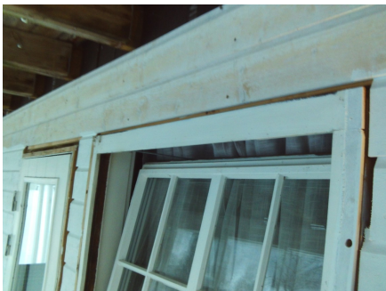
Mangler belistninger på fasade som er kledd på nytt.
