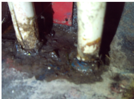
Usikker tetting i rundt rørgjennomføringer.
