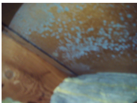
Noe mugg på undertaket enkelte steder.
