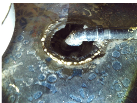
Ingen god tetting i rundt sluke.
