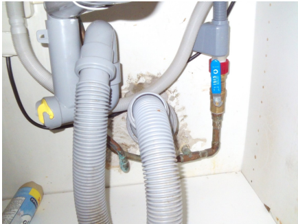
Røropplegg i kjøkkenbenken
