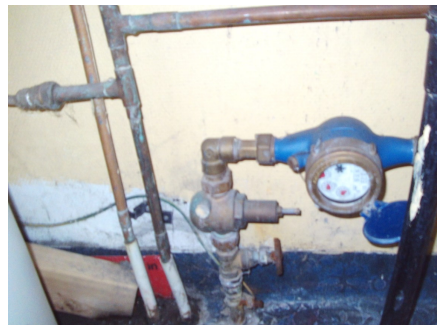
Innvendig stoppekran med vannmåler på vaskerommet.
