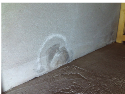
Fukt søk direkte på grunnmur i to boder.
