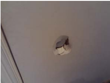
Slagskade på dør til toalettrom.
