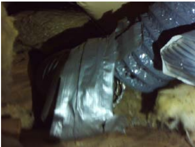
Brudd på ventilasjonsslange på knekott.
