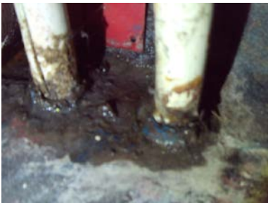
Usikker tetting i rundt rørgjennomføringer.
