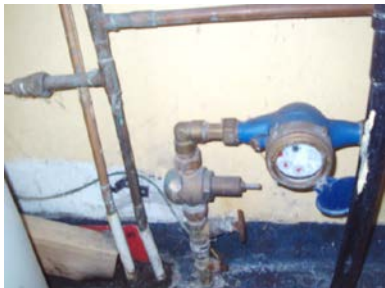
Innvendig stoppekran med vannmåler på vaskerommet.
