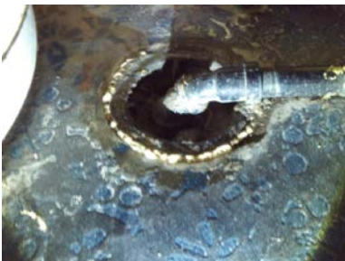
Ingen god tetting i rundt sluke.
