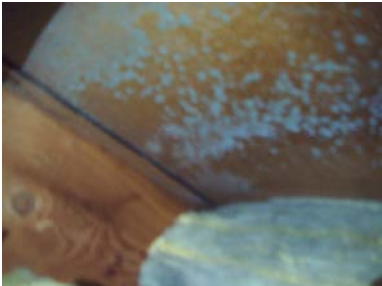
Noe mugg på undertaket enkelte steder.
