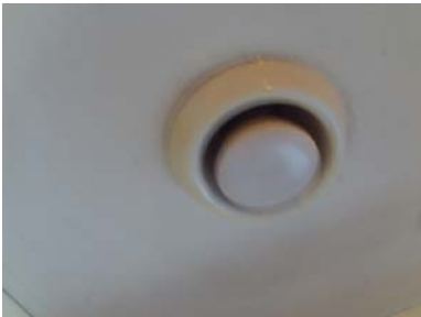
Naturlig avtrekk i himling.
