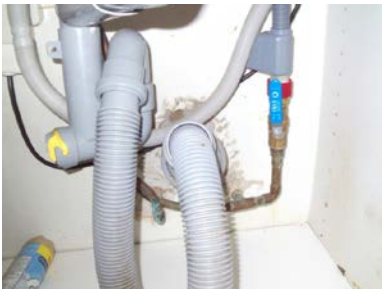
Rørøpplagg i kjøkkenbenken
