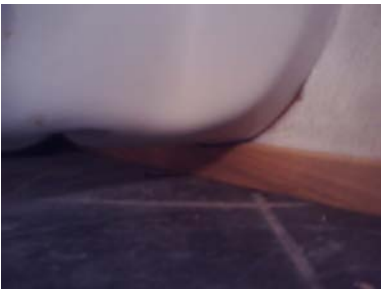
Ingen synlig hull for avrenning ved vegghengt toalett.
