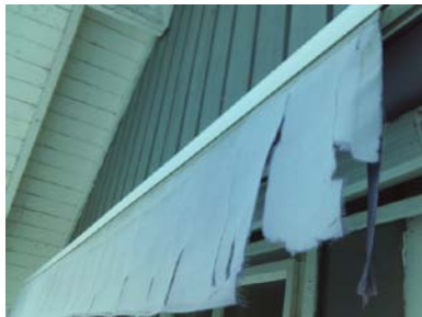
Duk hat større skader.
