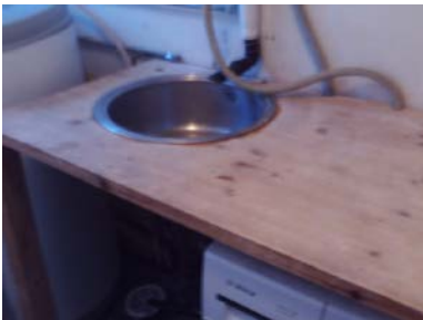
Arbeidsbenken er løs og har nå større skjevheter.
