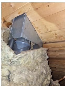
Noe eldre fuktmerker i underpanelet ved luftehaten. Ingen fukt på befaringsdagen
