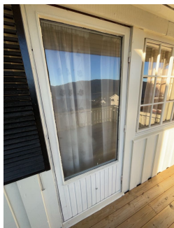
Verandadør på soverom 2 i 1. etasje er punktert
