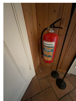
Brannslukker i underetasjen fra 2004
