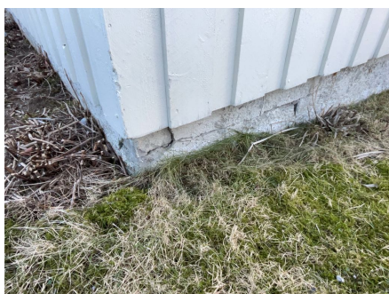
Sprekk/skader i grunnmur på garasje
