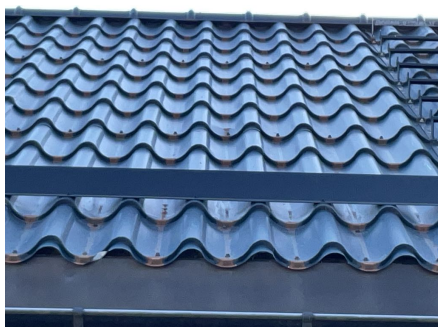
Synlig rust på takteking
