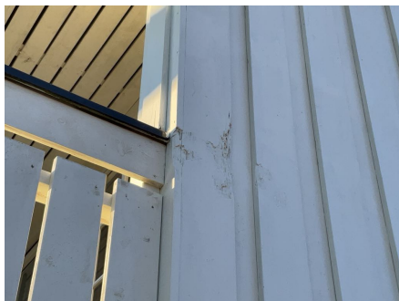
Skade på ett hjørnebord ved veranda
