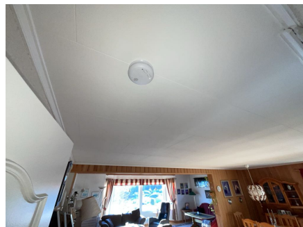
Brannmelder på stue i 1. etasje
