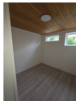
Bilde er tatt 03.09.2025 og viser at soverom mot terreng er renoveret i sin helhet etter tidligere fuktskade.
