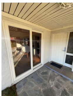
Skyvedør i underetasje til stue har punkterte glass. Malt hoveddør med kodelås.
