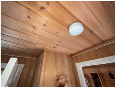
Brannmelder i gang underetasje
