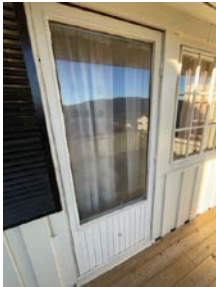
Verandadør på soverom 2 i 1. etasje er punktert
