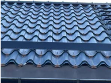
Synlig rust på taktekking
