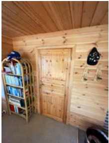
Dør til lagerrom/bod tar i karm sett fra stue i underetasje
