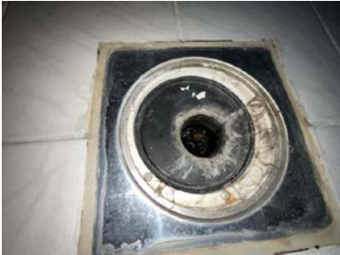
Sluk uten noe synlig membran
