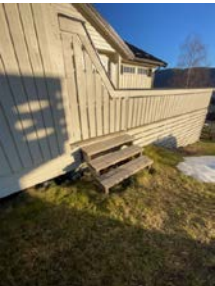
Det er 60 cm høyde til terreng for trapp uten rekkverk
