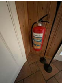
Brannslukker i underetasjen fra 2004
