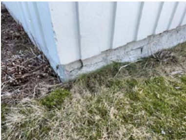
Sprekk/skader i grunnmur på garasje
