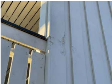
Skade på ett hjørnebord ved veranda
