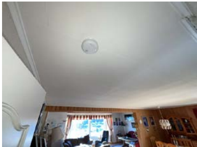
Brannmelder på stue i 1. etasje
