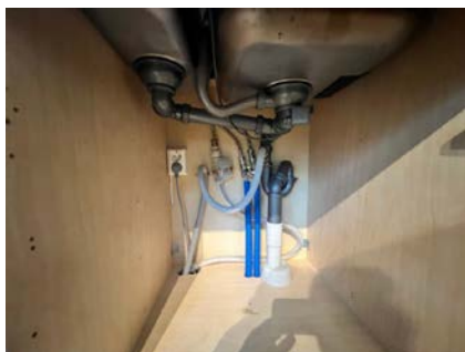
Røropplegg under kjøkkenben
