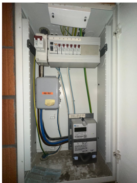
Sikringsskap plassert i felles oppgang.
