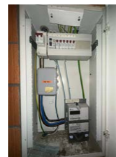
Sikringsskap plassert i felles oppgang.
