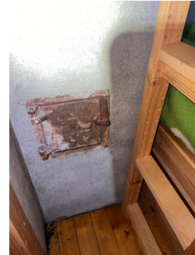
Manglende ubrennbar plate på gulv under sotluke
