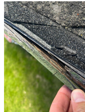
Fuktpreget undertakro ved takfot er registrert
