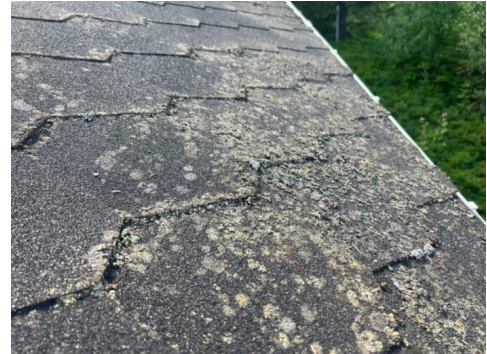
Slitasje med mosedannelse der forventet levetid er oppbrukt
