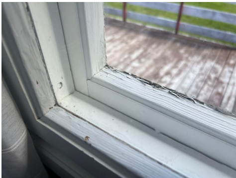
Slitasje på vinduer
