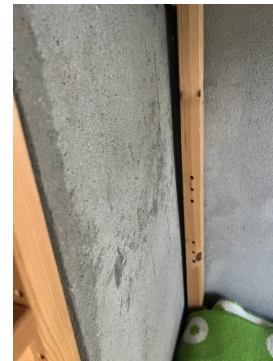
Brennbart materiale er plassert nær pipe
