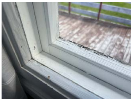
Slitasje på vinduer
