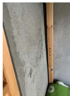
Brennbart materiale er plassert nær pipe
