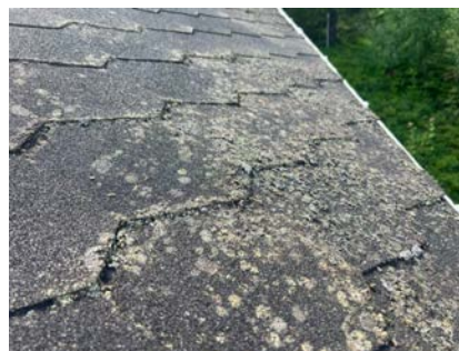
Slitasje med mosedannelse der forventet levetid er oppbrukt
