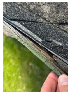
Fuktpreget undertakro ved takfot er registrert
