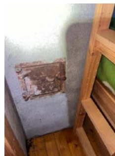
Manglende ubrennbar plate på gulv under sotluke
