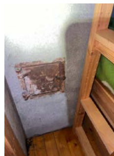
Manglende ubrennbar plate på gulv under sotluke
