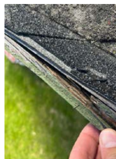
Fuktpreget undertakro ved takfot er registrert
