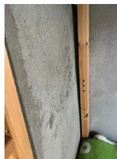
Brennbart materiale er plassert nær pipe
