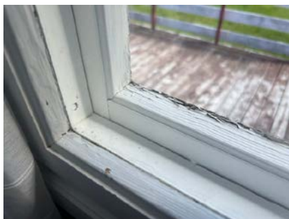
Slitasje på vinduer
