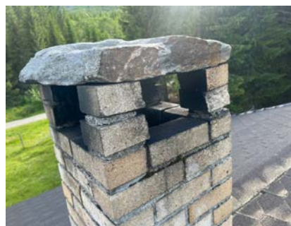
Toppelle og hjørnestein er løse
