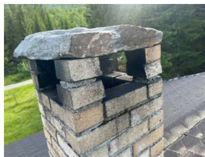
Toppelle og hjørnestein er løse
