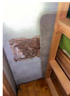
Manglende ubrennbar plate på gulv under sotluke
