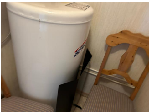
Varmtvannsbereder i bod.
