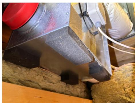
Mekanisk vifte i loft.
