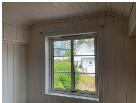
Ventiler i vinduer
