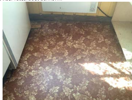
Bildet viser at gulvkonstruksjonen på kjøkkenet har kollapset.
