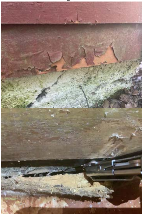
Bildet viser råteskadet bunnsvill på kjøkken.
