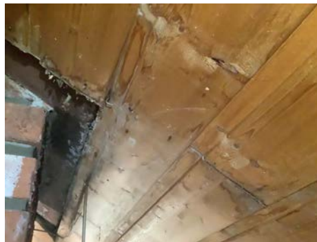
Bildet viser fuktskjolder i panel rundt pipe.
