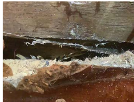
Bildet viser råteskadet bunnsvill.
