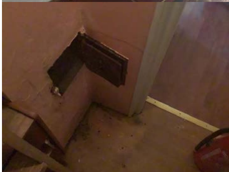
Bildet viser at det mangler ubrennbar plate under sotluke, at at det er for liten avstand mellom sotluke og brennbart materiale.
