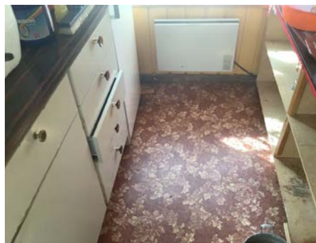
Bildet viser at gulvkonstruksjonen har falt sammen på kjøkkenet.
