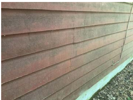
Bildene viser værslitt bordkledning.
