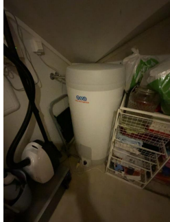
Varmtvannsbereder montert i bod.
