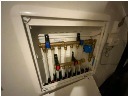
Fordelerskap i bod med stoppekran.
