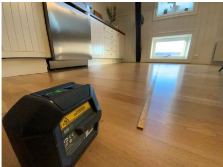
Helningsavvik på 45mm ble målt i kjøkken mot yttervegg
