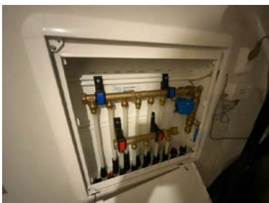
Fordelerskap i bod med stoppekran.
