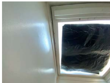
Det er har tidligere blitt observert vanninntrenging ved takvindu på soverom.
