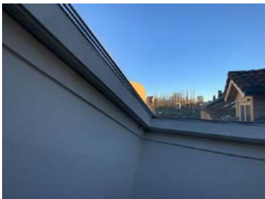
Takvindu på bad er vanskelig og åpne.
