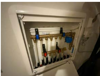
Fordelerskap i bod med stoppekran.
