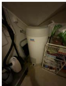
Varmtvannsbereider montert i bod.
