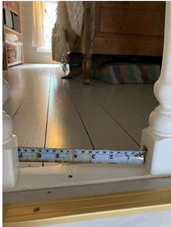
For stor avstand mellom rekkverkstolpene på hems.
