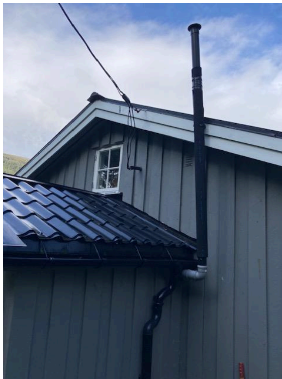
Ventiler i røstveggene. Avtrekk fra toalett.
