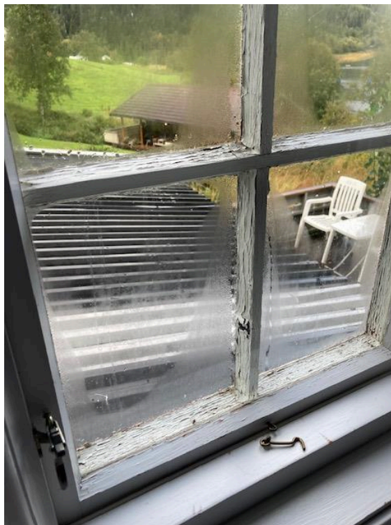
Vindu i et av soverommene har dugg og avflasket maling.
