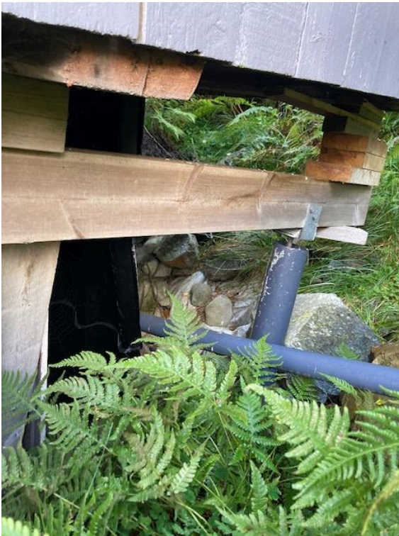
Skjevheter i fundamenteringen.
