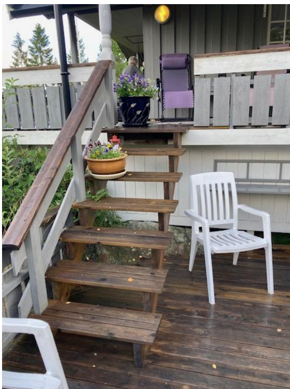
Trapp mangler rekkverk på den ene siden.
