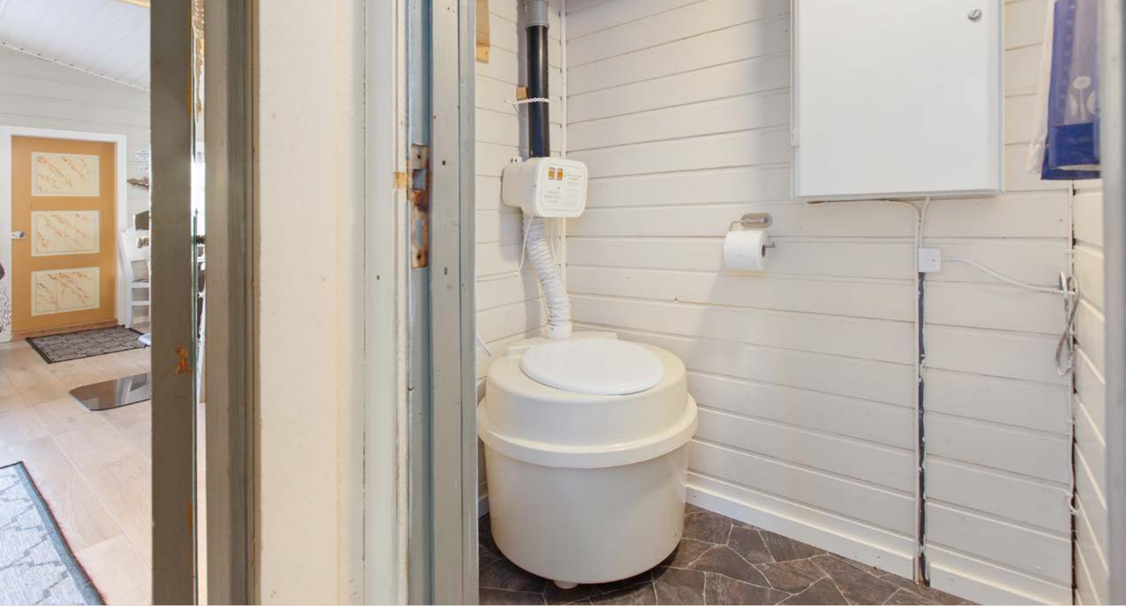
Toalett av typen Separett. Montert brukt i 2018
