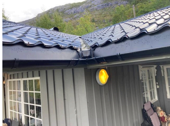
Noe rust i nedre kant på ståltaket. Mangler snøfangere.
