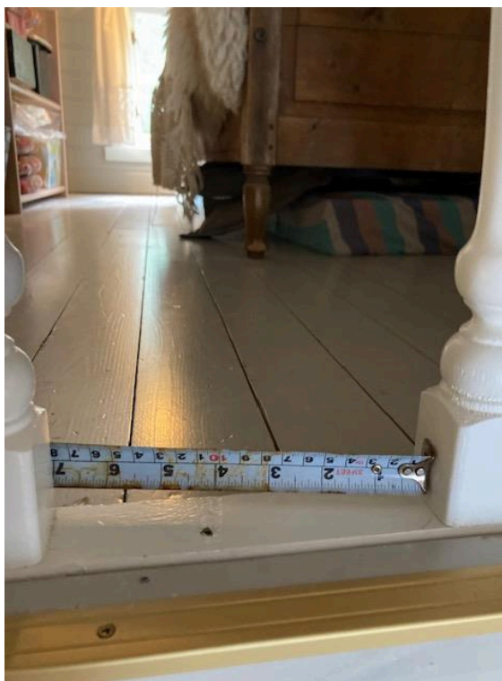
For stor avstand mellom rekkverkstolpene på hems.
