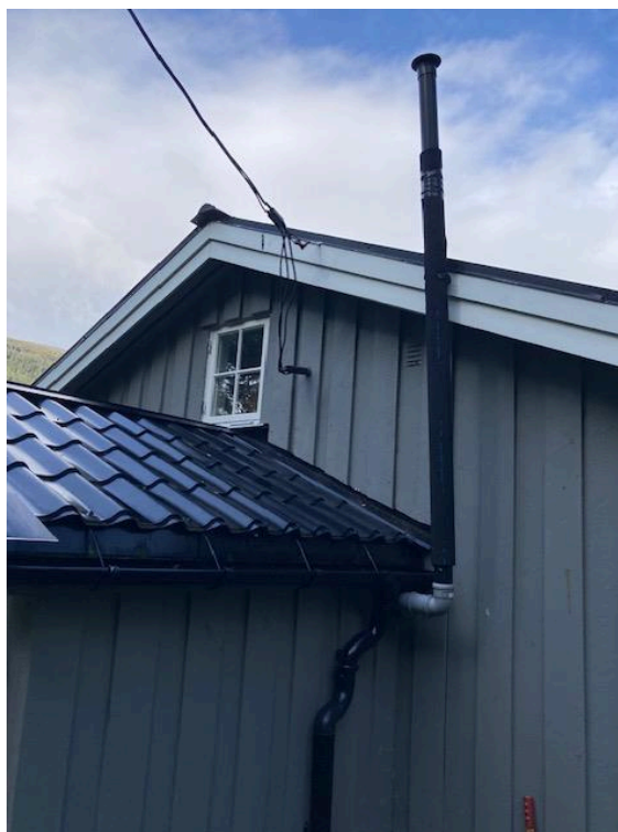
Ventiler i røstveggene. Avtrekk fra toalett.
