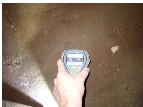
Fuktmåling på gulv viser høye verdier.
