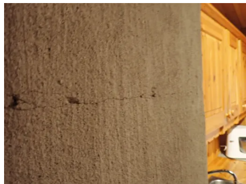
Sprekker i pipemur.
