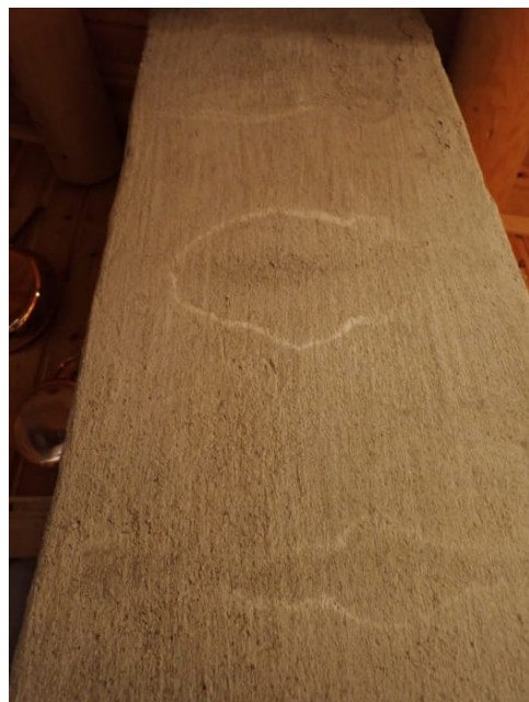
Skjolder i pipemur.
