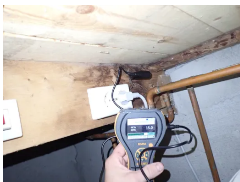
Misfarget treverk. Fuktmåling viser et nivå rett oppunder faregrensen for muggutvikling.
