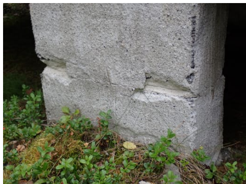
Sprekk/avskalling i fundament.
