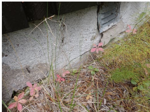
Sprekker i nedre del av ringmur.
