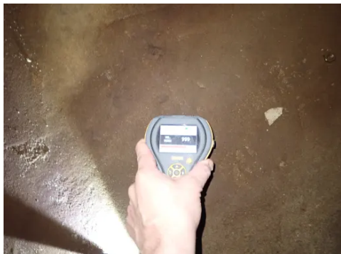
Fuktopptrekk i gulv.
