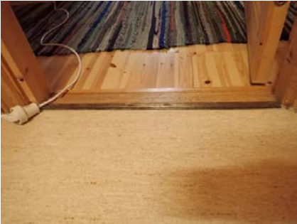
Vann vil kunne renne ut ved dør ved en lekkasje i rommet.
