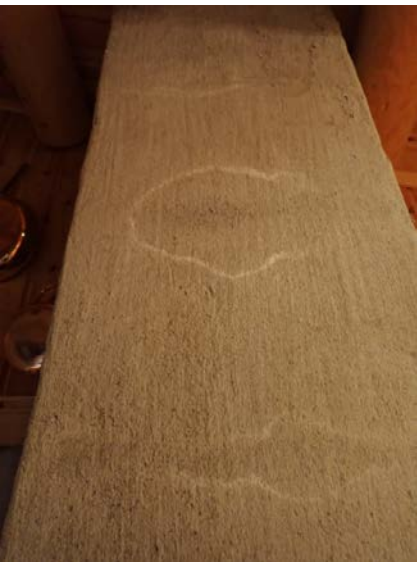
Skjolder i pipemur.
