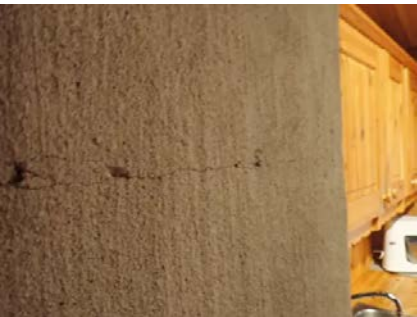
Sprekker i pipemur.
