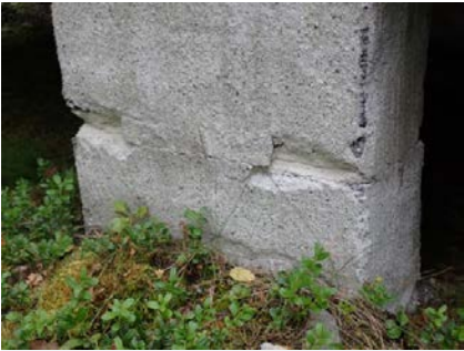
Sprekk/avskalling i fundament.
