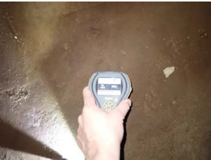
Fuktopptrekk i gulv.
