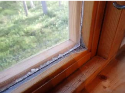
Fuktmerker/avskalling i innvendig vinduskarm.
