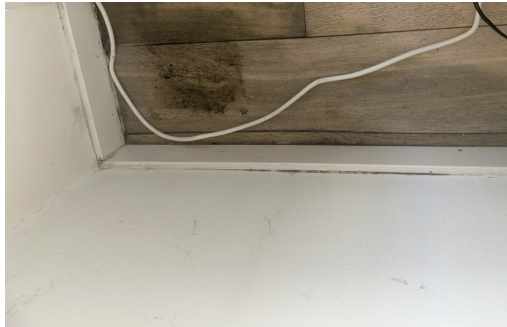
Fuktskade i par
