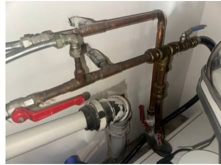
Stoppekraner plassert på kjøkken
