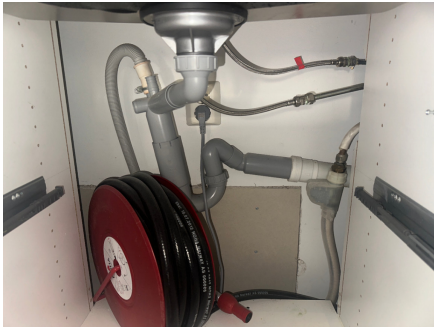
Røropplegg i kjøkkenbenk
