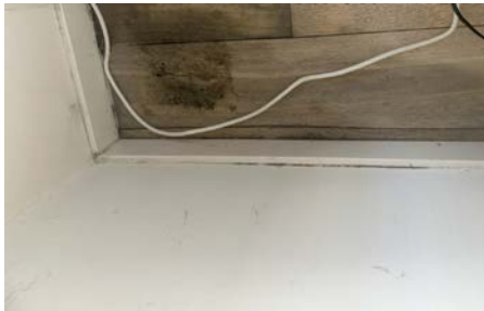
Fuktskade i par
