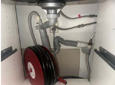
Røropplegg i kjøkkenbenk
