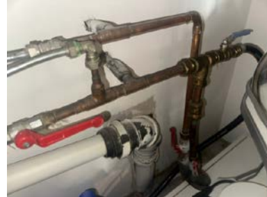
Stoppekraner plassert på kjøkken
