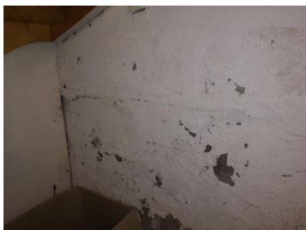
Sprekker i grunnmur.
