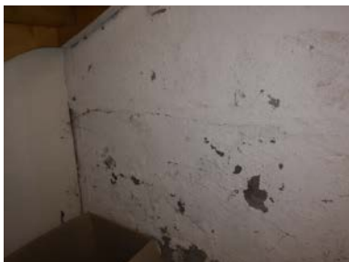
Sprekker i grunnmur.
