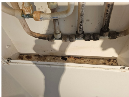
Rust i bunn av fordelerskap
