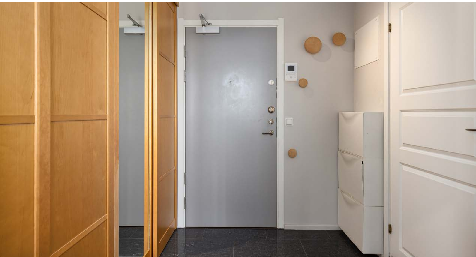
Det er montert dørtelefon med portåpner og kamera/monitor.
