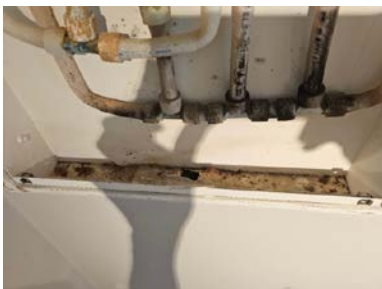
Rust i bunn av fordelerskap
