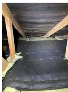
Undertak av plater har sverte/fuktmerker.
