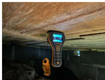
Fuktmåling viste skadelig fukt i himling med mugg eller sopp.
