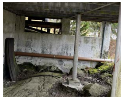
Avløpsrør må frostsikres.
