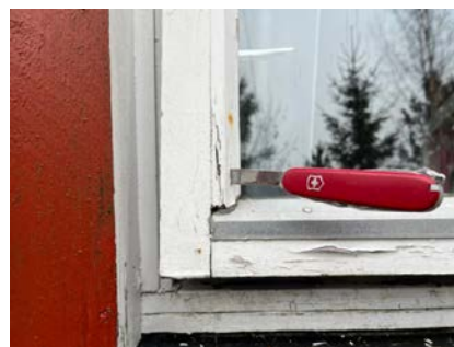
Råteskader i utvendig vindusramme.
