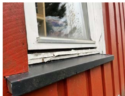
Utvendig slitasje på vindu.
