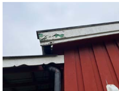
Vindskier må utbedres.
