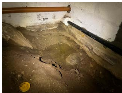
Jordmasser med stående vann.
