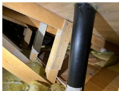
Uisolerte rør på møneloft må isoleres.
