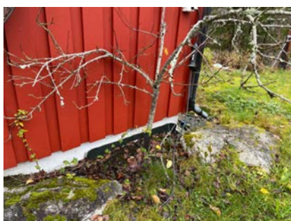
Terreng med fall inn mot bygning.
