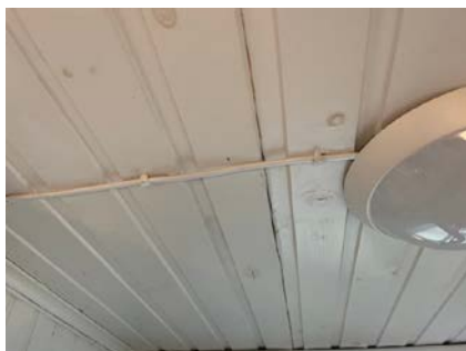
Panel i himling har krympet fra hverandre.
