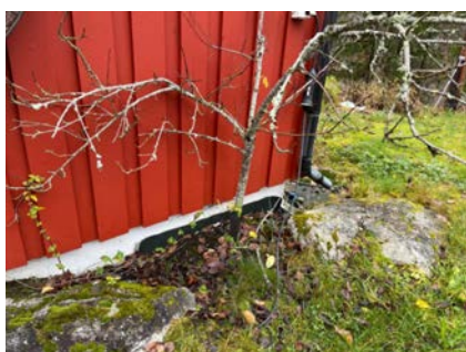
Terreng med fall inn mot bygning.
