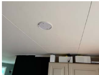
Røykvarsler er nedkoblet.
