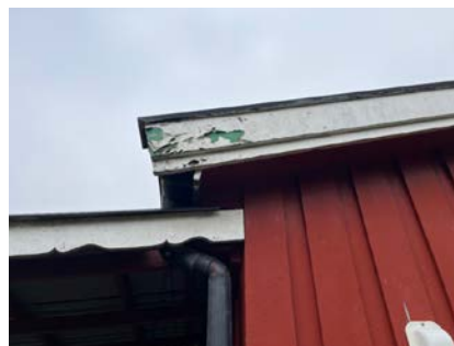
Vindskier må utbedres.
