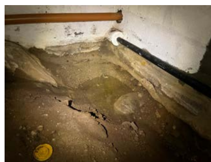
Jordmasser med stående vann.
