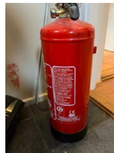
Brannslukningsapparat er datert 2007.
