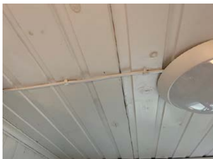
Panel i himling har krympet fra hverandre.
