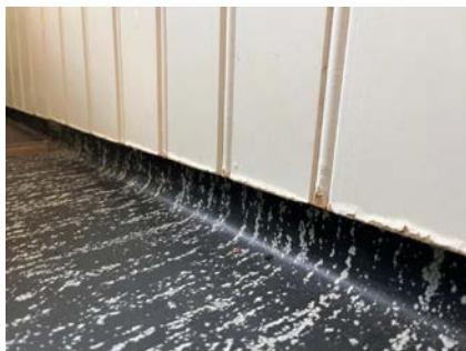
Veggplater har fuktskader bl.a. i nedkant.
