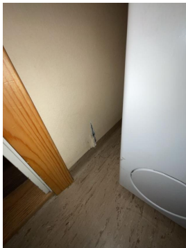
Skade i belegg på vegg ved vaskemaskin
