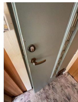
Slitasje etter bruk på hoveddør
