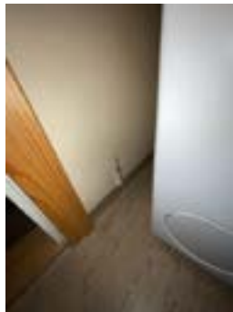
Skade i belegg på vegg ved vaskemaskin
