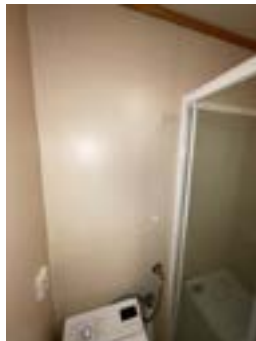
Skruehull bør tettes med silikon/mykfuge
