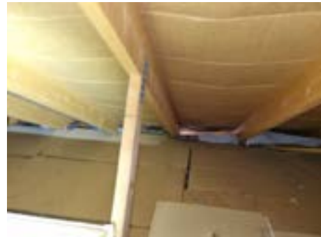
Synlig ventilering på kryploft
