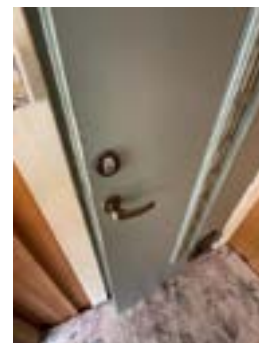
Slitasje etter bruk på hoveddør
