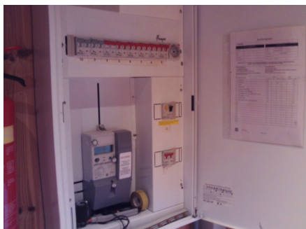
Sikringsskapet er plassert i gangen.
