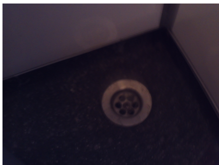
Et mindre avløp i gulvet med tanke på en lekkasje.
