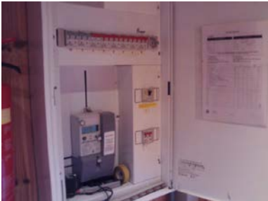
Sikringsskapet er plassert i gangen.
