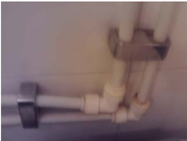
Synlige pexrør med koblinger.
