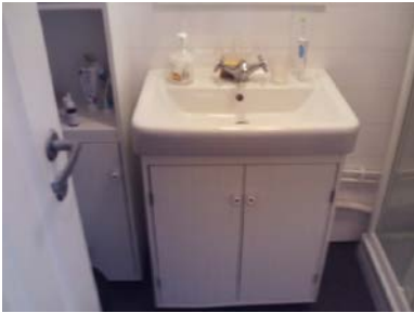
Innredning med servant
