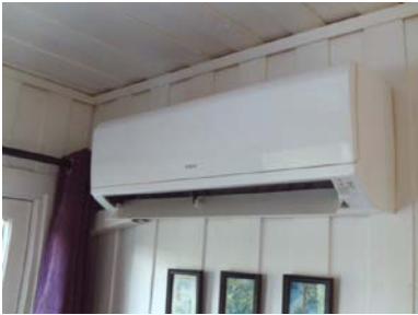
Varmepumpe i stue.
