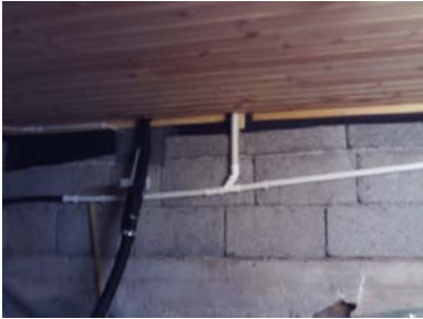
Avløpsrør av plast i krykjeller.
