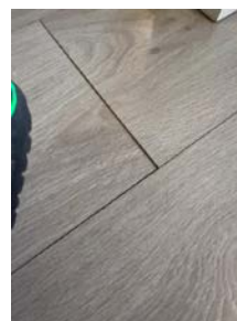
I døråpningen mellom stue/kjøkken og gangen svikter gulvet grunnet ujevnheter i undergulvet.
