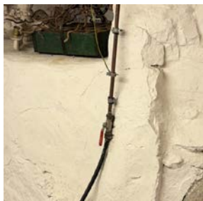
Stoppekran på vestveggen i bod i kjeller
