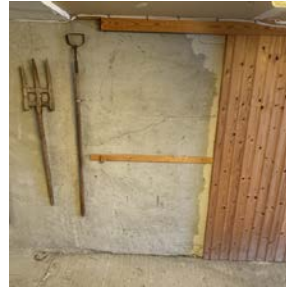
Sprekk i skillevegg mellom garasje og bod
