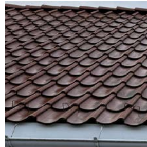
Snøfanger kun montert ved takfot
