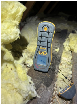
Bemerket fukt i konstruksjon under avtrekkør og ved fuktmåletaking var det fuktutslag
