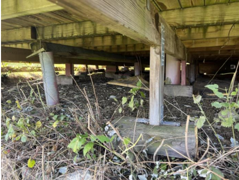
Enkel fundamenter på terreng som må skiftes
