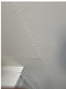
Fuktmerker i himling fra tidligere lekkasje i stue og kjøkken
