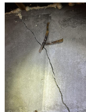
Sprekk i mur, bør holdes under tilsyn og tiltaksbehov vurderes
