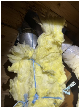
Avtrekkør er ikke tilstrekkelig isolert og ikke ført tilstrekkelig over tak
