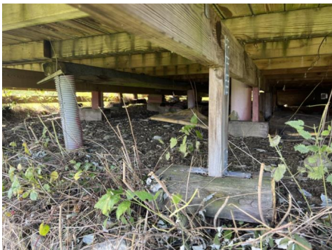
Enkel fundamenter på terreng som må skiftes
