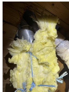
Avtrekkstrør er ikke tilstrekkelig isolert og ikke ført tilstrekkelig over tak
