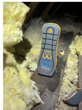
Bemerket fukt i konstruksjon under avtrekkstrør og ved fuktmåletaking var det fuktutslag
