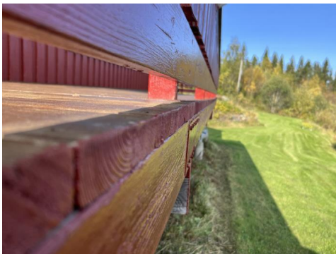
Skjevheter i terrasse
